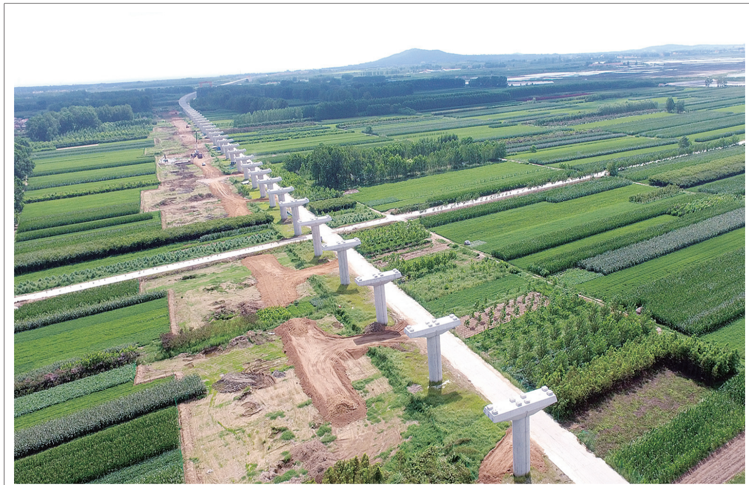
近日,二公司承建的青岛地铁13号线二期工程管段内全部278个盖梁全部完成。
