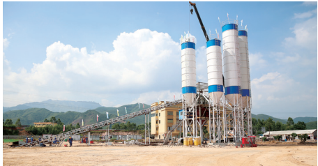
贵隆高速项目 A03 标拌和站
