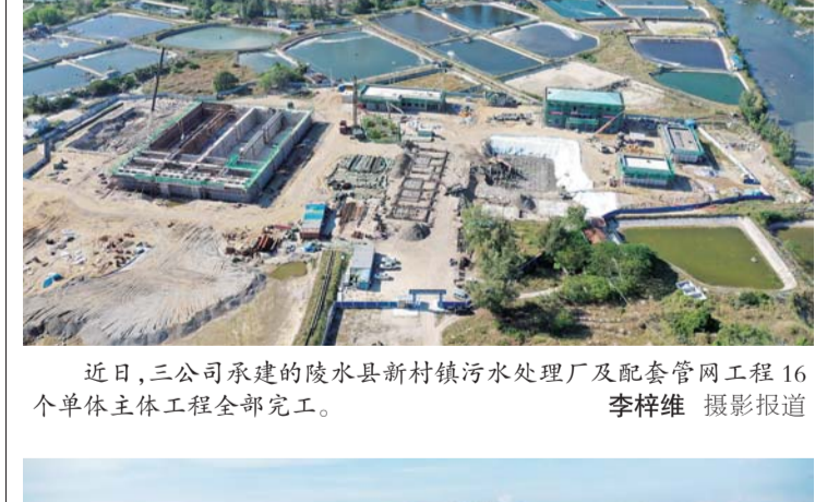
近日，三公司承建的陵水新村镇污水处理厂及配套管网工程16个单体主体工程全部完工。 李祥维 摄影报道
