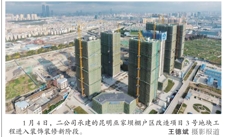
昆明巫家坝棚户区改造项目3号地块工程进入装饰装修新阶段。 王德斌 摄影报道
