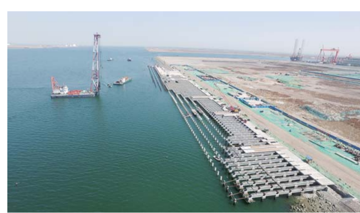
近日,一公司承建的天津港大沽口粮油区6、7号通用泊位工程码头施工项目海上方桩沉设已全部完成,方桩桩帽施工超过80%。
