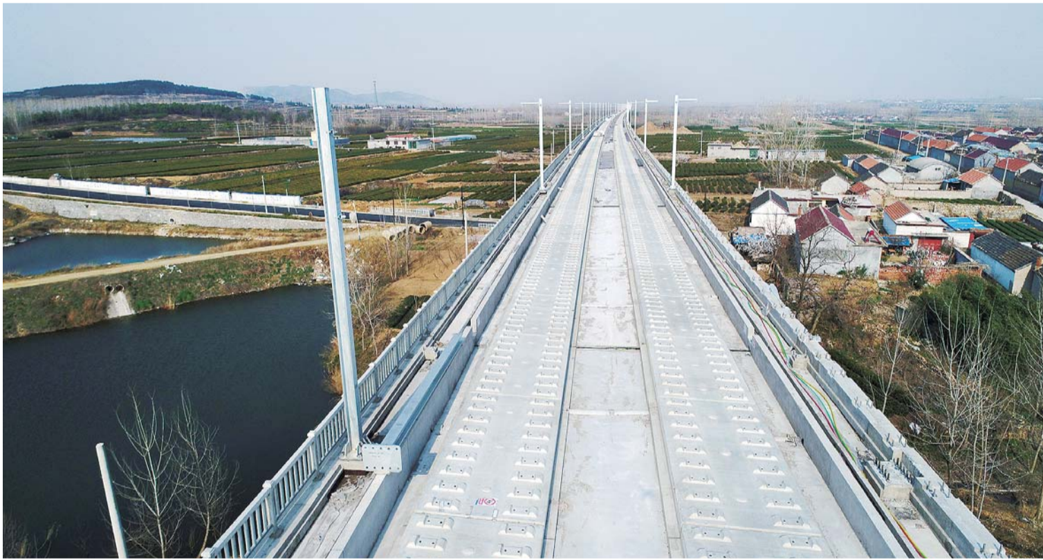
近日,公司鲁南高铁项目无砟轨道施工完成,轨道施工里程全长17.62正线公里,为CRTSIII型板式无砟轨道。施工中,项目部对自密实混凝土配合比进行多次调整,验证并制定了最优方案,确保了后续无砟轨道施工的连续作战。该节点顺利完成,为鲁南高铁全线通车提供了保障。
