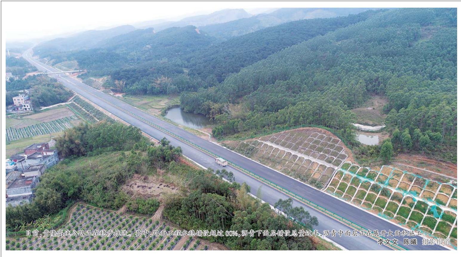
目前,甬甌高速公路正在稳步推进。其中,路面工程水稳铺设超过80%,沥青下面层铺设总过半,沥青中面层正在展开大面积施工。 李文文 陈曦 摄影报道
