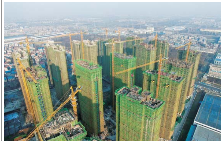
近日,四公司承建的湖北襄阳市樊城柿铺片区棚户区改造EPC总承包项目24栋住宅楼主体结构全部封顶。
