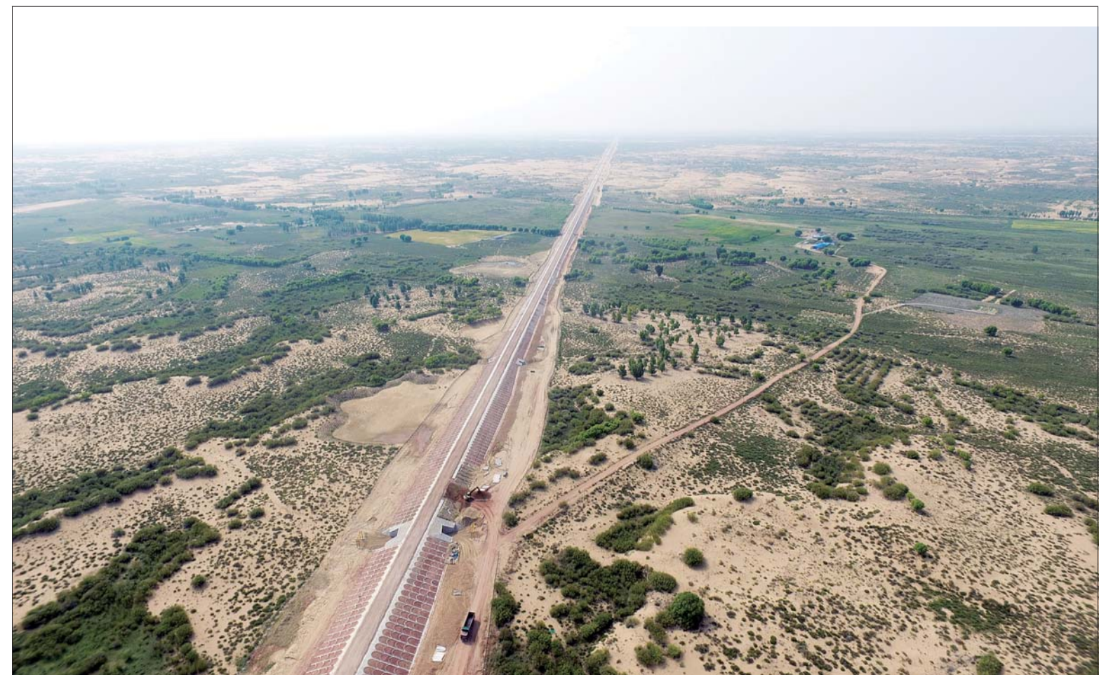
10月6日,随着泵车的大臂缓缓收起,蒙华铁路项目最后一座涵洞主体浇筑成型,标志着公司承建的蒙华铁路所有涵洞全部完工,为后续铺架施工的顺利进行创造了良好条件。涵洞311座,长6853横延米,首座涵洞工程于2016年4月开工。赵海潮 魏建强 摄影报道
