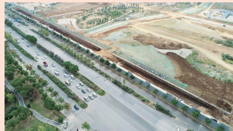
武汉光谷中心城综合管廊 郑一柳 摄
