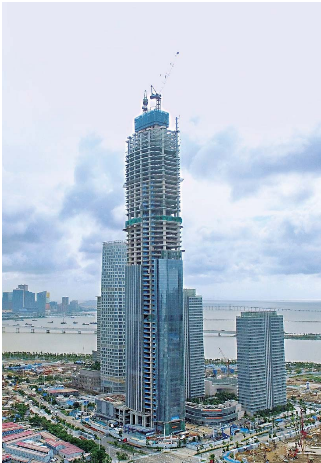
7月6日,随着最顶层混凝土泵送完毕,中交第一高楼汇通横琴广场3号主塔楼核心筒顺利封顶。历时1115天,近300米的摩天大厦,“漫步”云端。横琴广场是集团首个超高层高端城市综合体开发项目,集5A甲级办公、总部式办公、餐饮、展示、服务、住宅等功能于一体。郭卫华 摄影报道
