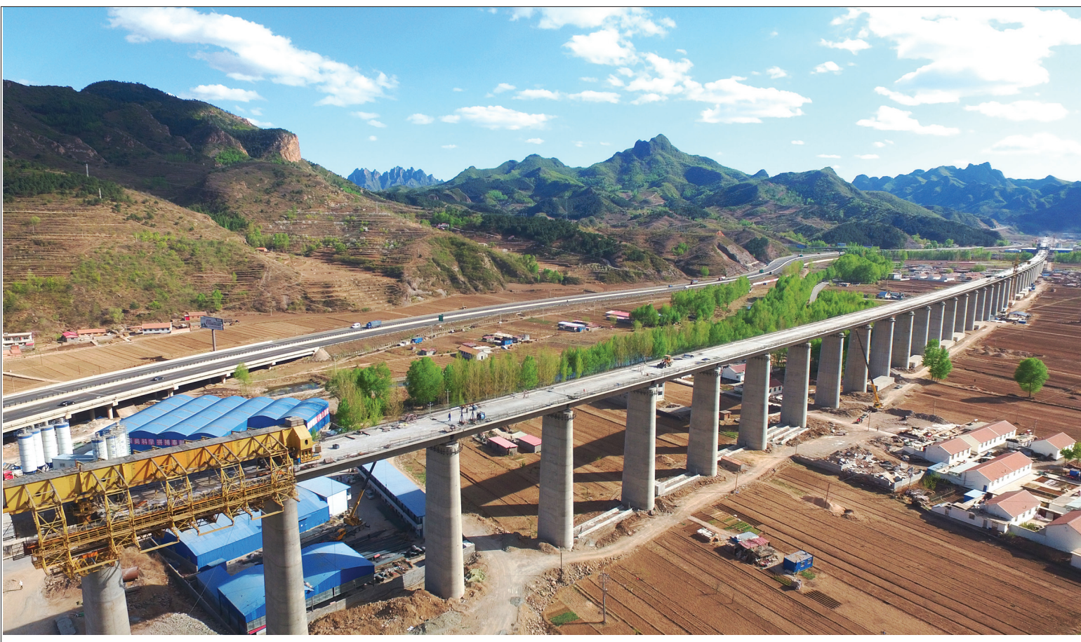
京沈客专白河特大桥下部结构日前全部完工,大桥全长2410米。图为白河特大桥最后一个墩台施工场景。
