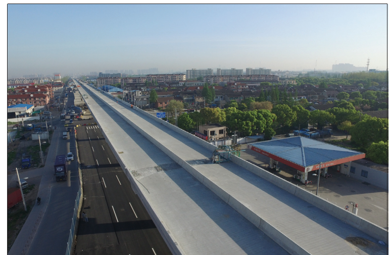
日前,一公司第七项目部承建的上海虹梅南路高架HM-3标实现桥梁主体贯通,正在紧张进行桥面系施工,预计6月底前通过验收通车。涂云贵摄影报道
